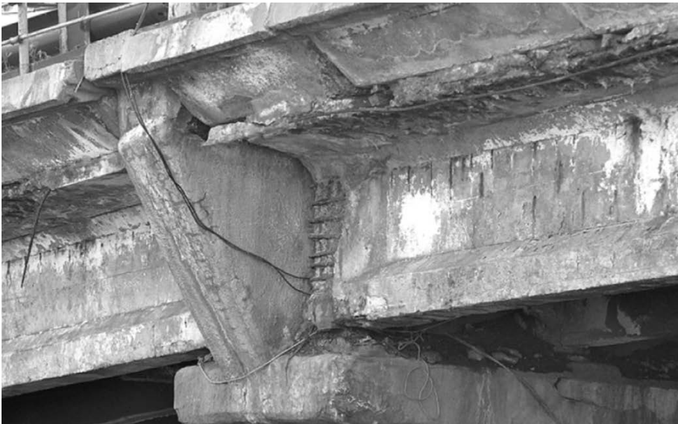
Рис. 2. Ділянка залізобетонного моста із активною корозією арматурної сталі
